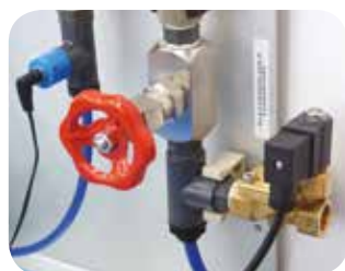
Valvola a spillo inox ed elettrovalvola di flussaggio.
