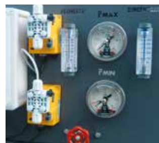
Manometro c/contatto, valvola a spillo e pompe dosatrici
