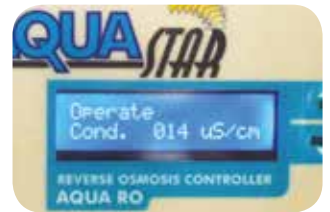
Programmatore elettronico con conduttivimetro per il controllo della qualità del permeato.
