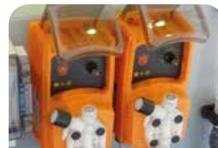
Pompe dosatrici per additivi di pretrattamento
