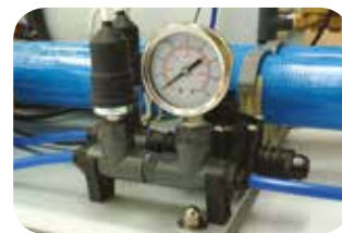
Gruppo di pressostati di minima, massima e manometro.
