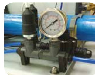
Gruppo di pressostati di minima, massima e manometro.
