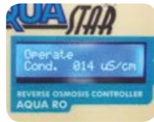
Programmatore elettronico con conduttivimetro per il controllo della qualità del permeato.
