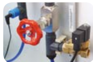
Valvola a spillo inox ed elettrovalvola di flussaggio.
