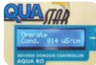
Programmatore elettronico con conduttivimetro per il controllo della qualità del permeato.
