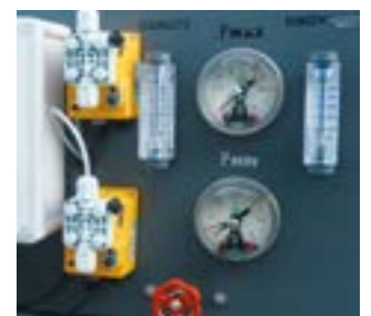
Manometro c/contatto, valvola a spillo, e pompe dosatrici
