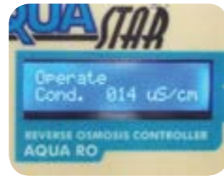
Automate programmable avec conductivimètre pour contrôler la qualité du perméat.
