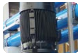
Groupe de pressurisation avec pompe verticale en inox.
